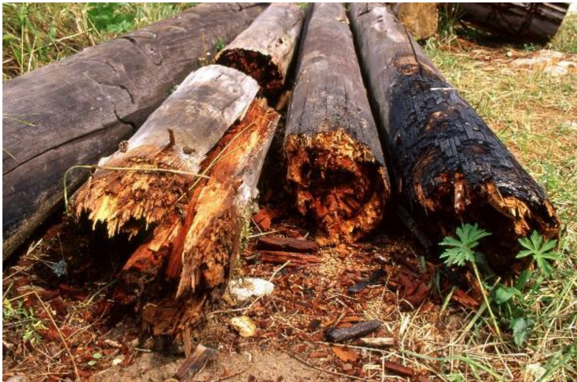
Obr. 7.2. Drevené koly ťažko poškodené hnilobou dreva.
