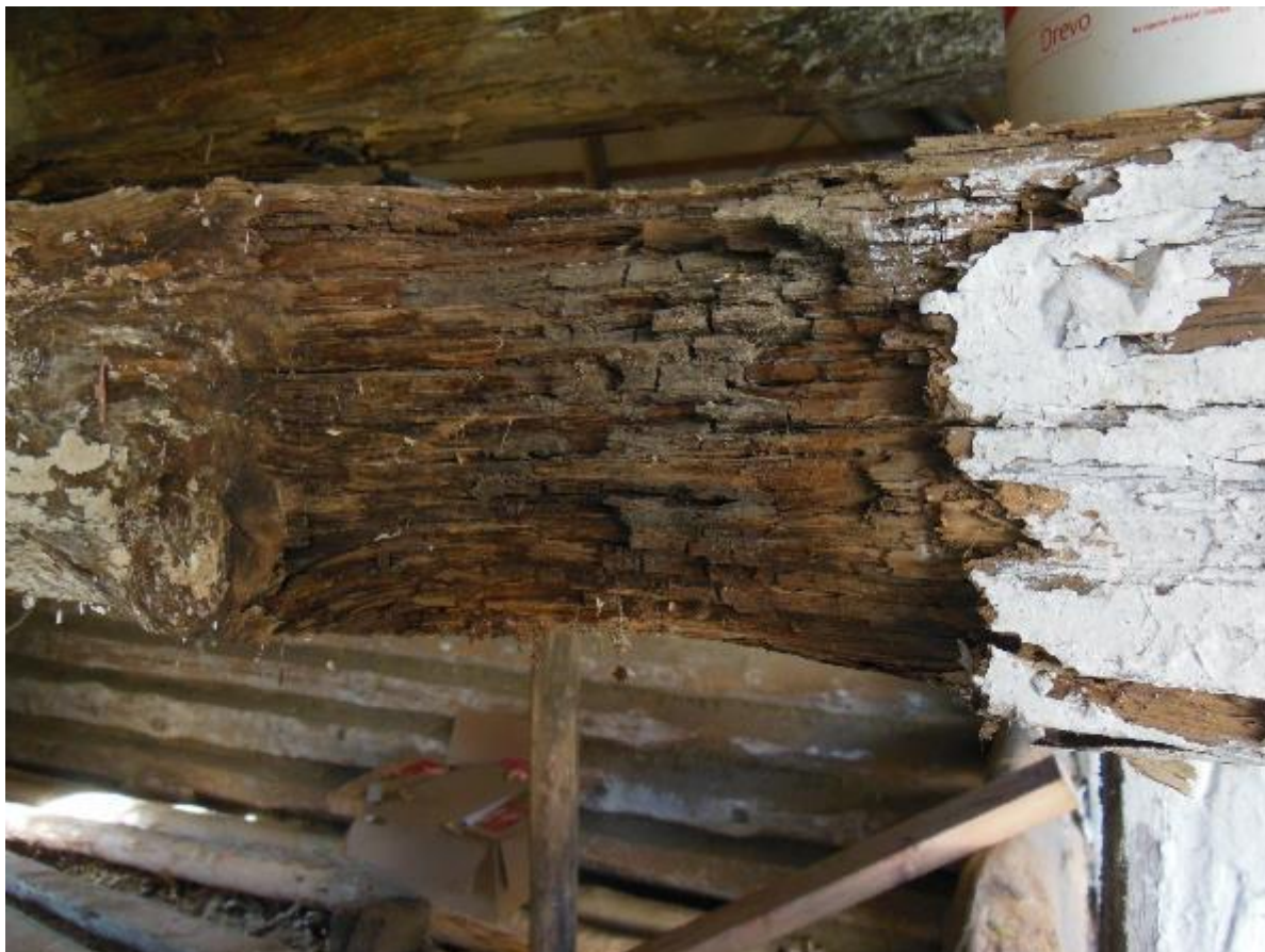
Obr. 8.2. Hlavný nosný trám stropnej konštrukcie (tragar) ťažko poškodený drevokaznou hubou.
