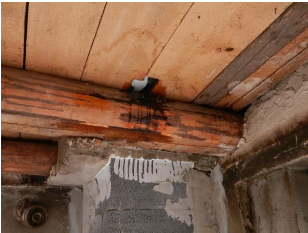
Obr. 8.3. Zatečený strop ako následok poruchy komína.
