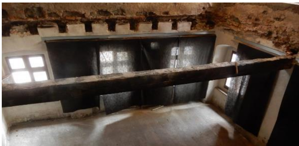
Obr. 7.4. Zachovaný stropný trám Pischlovho domu v Banskej Štiavnici po požiari.
