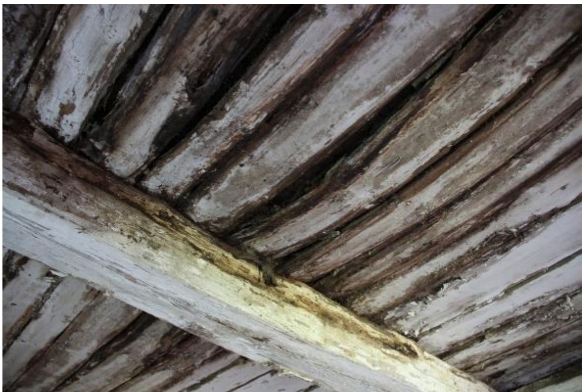
Obr. 8.1. Strop poškodený hnilobou dreva ako dôsledok zatekania zrážkovej vody do stavby.
